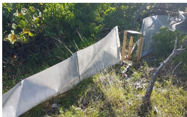
Figure 7. HALT 2 installé sur le grand îlet avec ses barrières de dérivation
